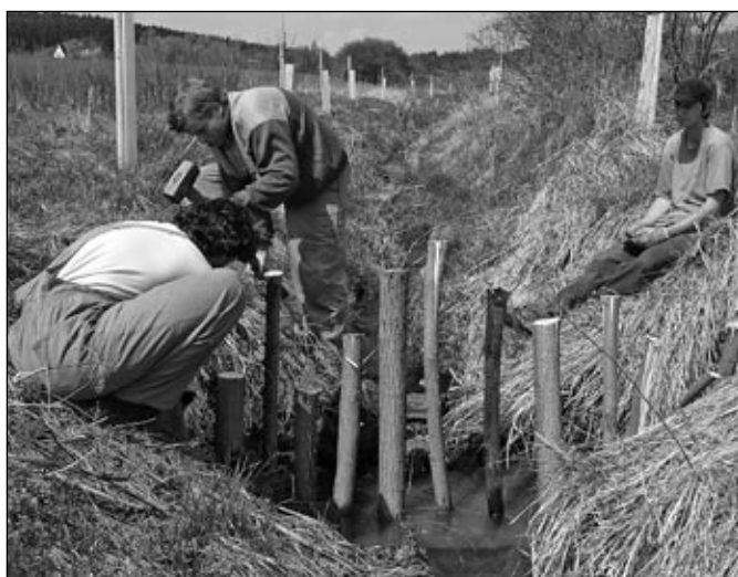
Při revitalizaci rybníka v Neustupově jsme na bezejmenném přítoku založili pokusné přehrážky z přírodních materiálů (vrbové kůly a proutě), které jsou levnější variantou řešení revitalizací zregulovaných toků. Foto: Marek Lempochner
